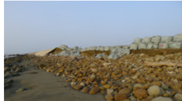
曾文溪出海口西海堤 _ 舊海堤被海水掏空出現破口 _20111026
