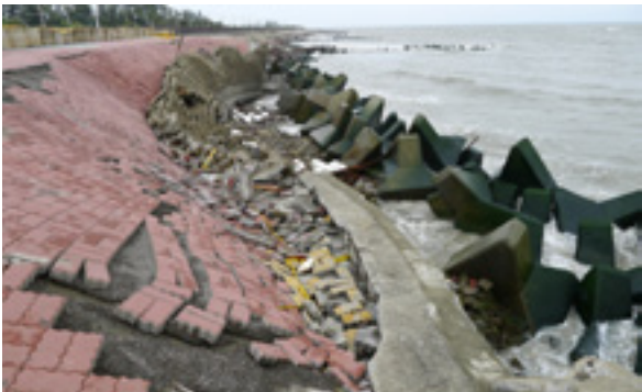
黃金海岸遊客中心前遭海水掏空，平台崩塌的情形—20110629
