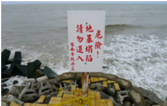
黃金海岸遊客中心前遭海水掏空，平台崩塌的情形—20110629
