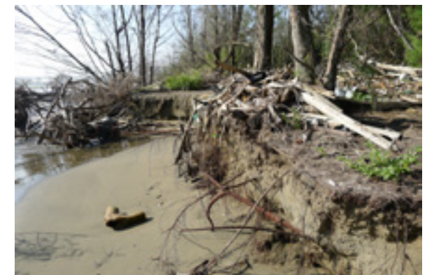
曾文溪出海口防風林，海水掏空沙灘挖出樹根的現場 20110524
